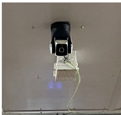
監視カメラ設置状況
