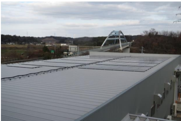
<太陽光発電システム>
