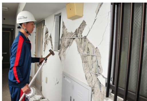
被災したマンションで住民が対応する様子
