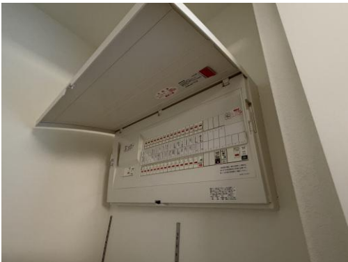
視察対象となった分電盤・感震ブレーカー 実機(LDK 収納内の壁面に設置)
