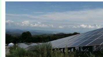
LS鳥取大山発電所(発電容量:14MW)
