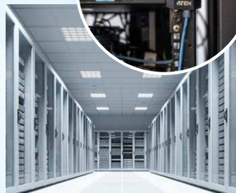
サーバールーム
